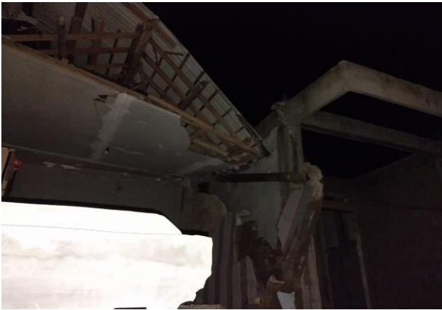
Gambar 7. Reruntuhan Rumah Warga didesa Cugenang yang terdampak Gempa Bumi - Cianjur
